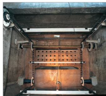
汚泥かき寄せ機
